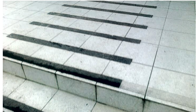
Escadas e Zona Pedonal Escorregadia LOCTITE PC 6261
