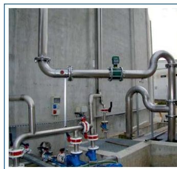
SISTEMA DE MONITORIZAÇÃO DE CAUDAL E QUALIDADE
