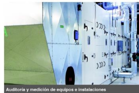
Auditoría y medición de equipos e instalaciones
